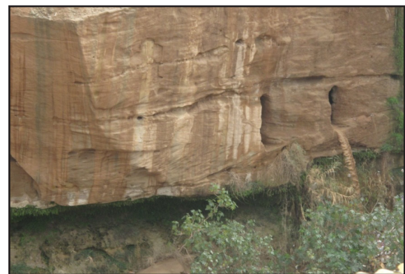
تصویر ۱۲. نمایی از درکار در بدنه صخره‌ای نهر گرگر (مأخذ: آرشیو پایگاه میراث جهانی سازه‌های آبی تاریخی شوشتر).
